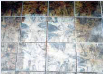
Rost auf Fliesen
